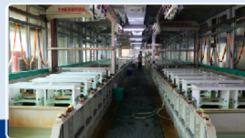
Plating 电镀车间
