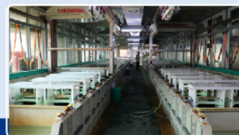
Plating 电镀车间
