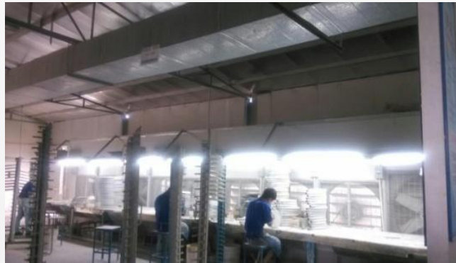
无尘抽风线 Ventilation system
